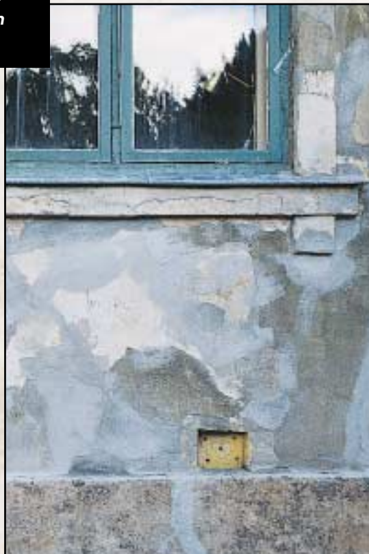
Pussutbedringer fra de mange overmalinger kommer fram som et lappeteppe etter fjerning.
